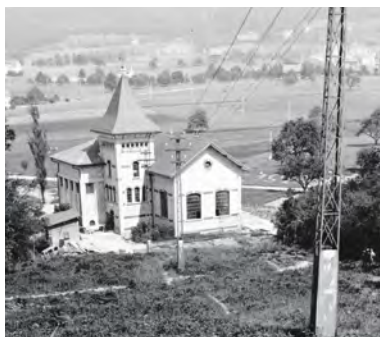
Der Strom aus dem Lettenwerk wurde im Guggach von 40 000 auf 6000 Volt reduziert. Hier das «Trafo Guggach» mit der Stromleitung vom Lettenwerk. (1909, BAZ).
